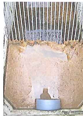
Entrée de station d'épuration obstruée par les lingettes
